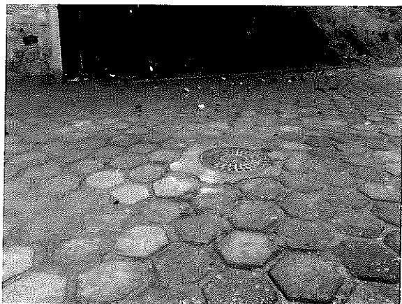
FIGURA 39 – REDE COLETORA DE ESGOTO (FONTE: ACERVO DO AUTOR, 2014)
