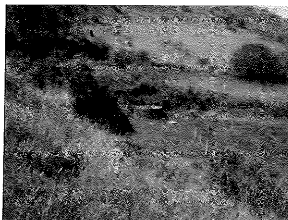
FIGURA 40 – FOSSA SÉPTICA – LOCALIDADE DE POUSO ALTO (FONTE: ACERVO DO AUTOR, 2014)
